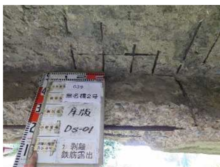
■ コンクリートの落下
