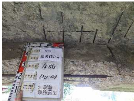
■ コンクリートの落下
