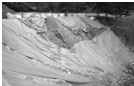
マキノ高原交流広場の災害現場
