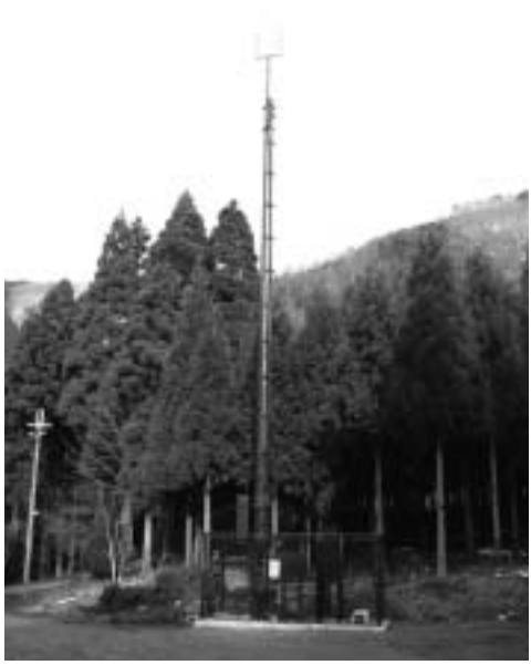
移動通信鉄塔(麻生横谷)
