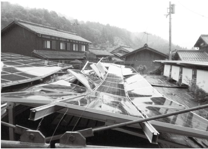
雪害で壊れたソーラーパネル
