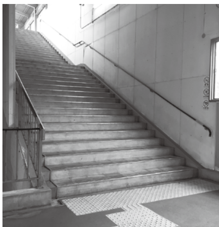
新旭駅構内の階段 早急なバリアフリー化が求められる
