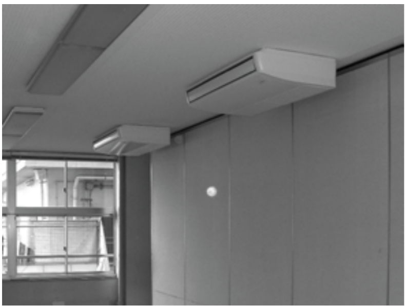
小学校に設置されているエアコン
