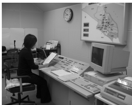
防災行政無線の放送室
