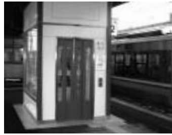
JR安曇川駅エレベーター
