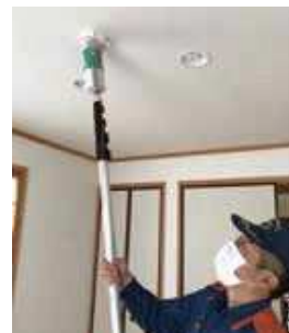
消防設備設置検査
