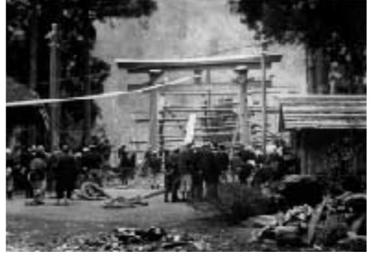
「大宮神社の鳥居建て(中牧)」 大宮神社の鳥居はおおよそ20年毎に建替えられていました。この写真は昭和28年に行われた最後の鳥居建ての様子を写した貴重な写真です。(提供：大津市在住 熊瀬昭太郎さん)
