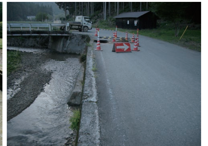
椋川日吉神社付近の市道陥没(今津町椋川)
