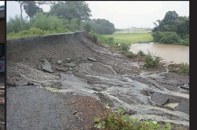
安曇川の川島堤防に浸透した水により、崩れた道路(安曇川町川島)
