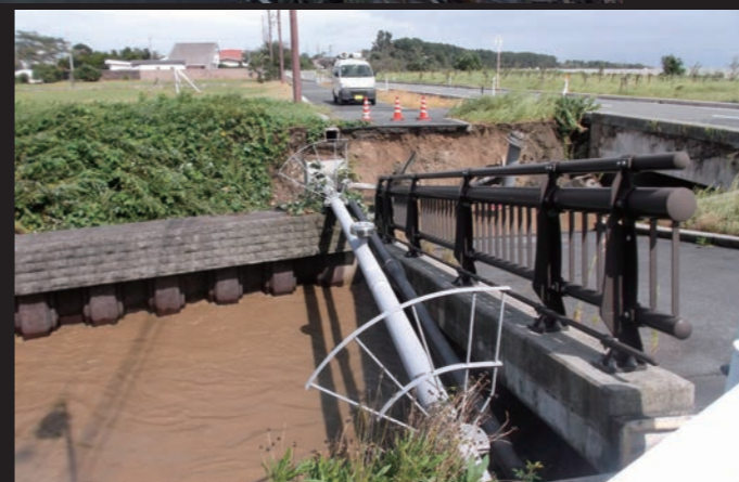
歩道が倒壊(高島萩の浜)
