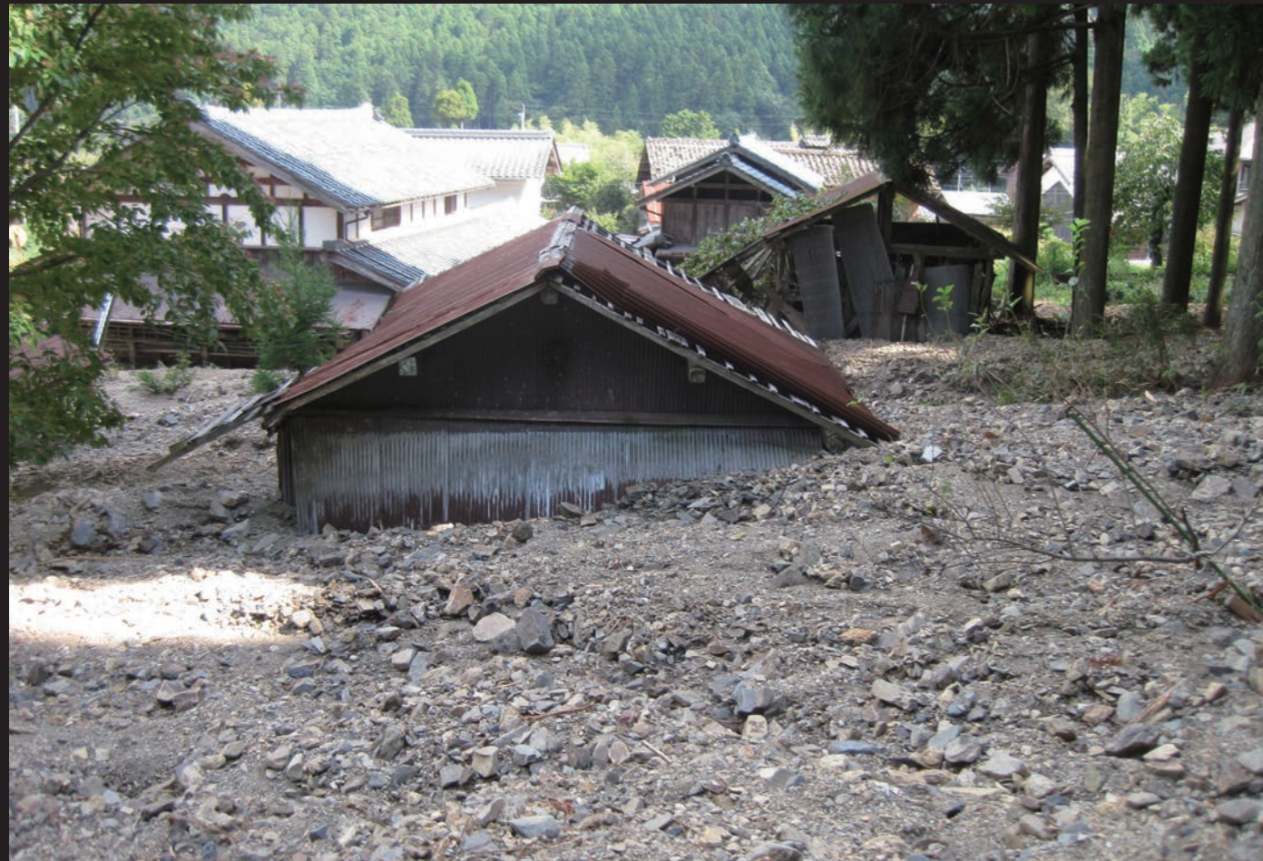
崩れた土砂で埋まった家(朽木古川)
