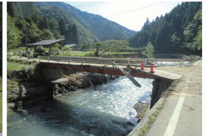
橋梁の被害(朽木小川)
