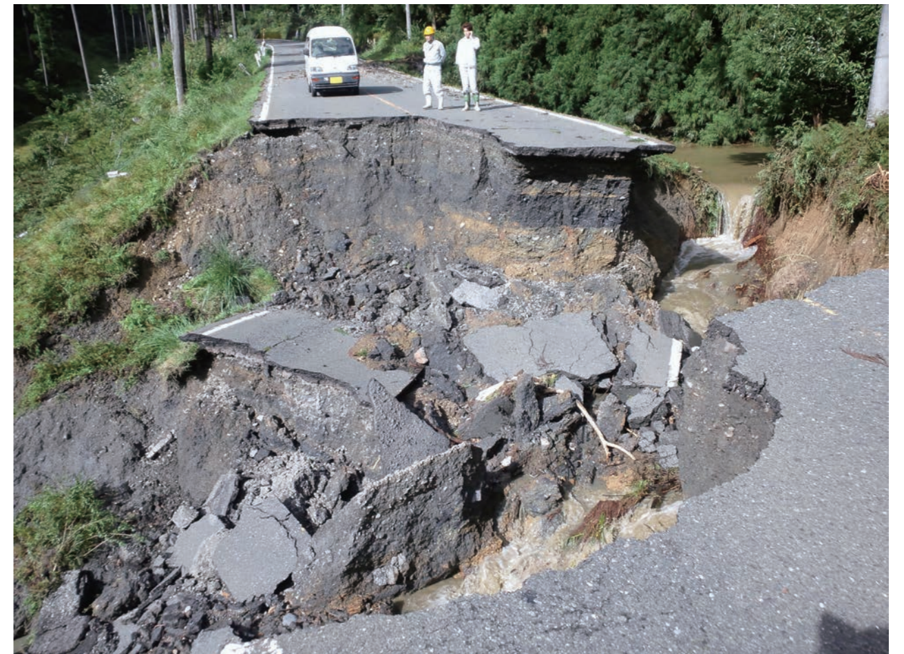
崩れた国道367号保坂～三ツ石間(朽木荒川)
