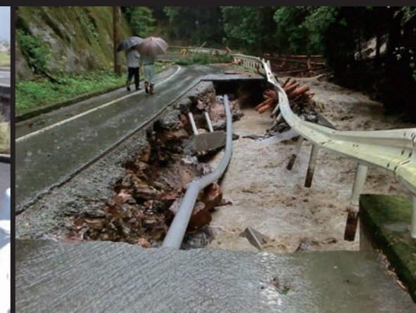
片側1車線が崩壊(高島畑)
