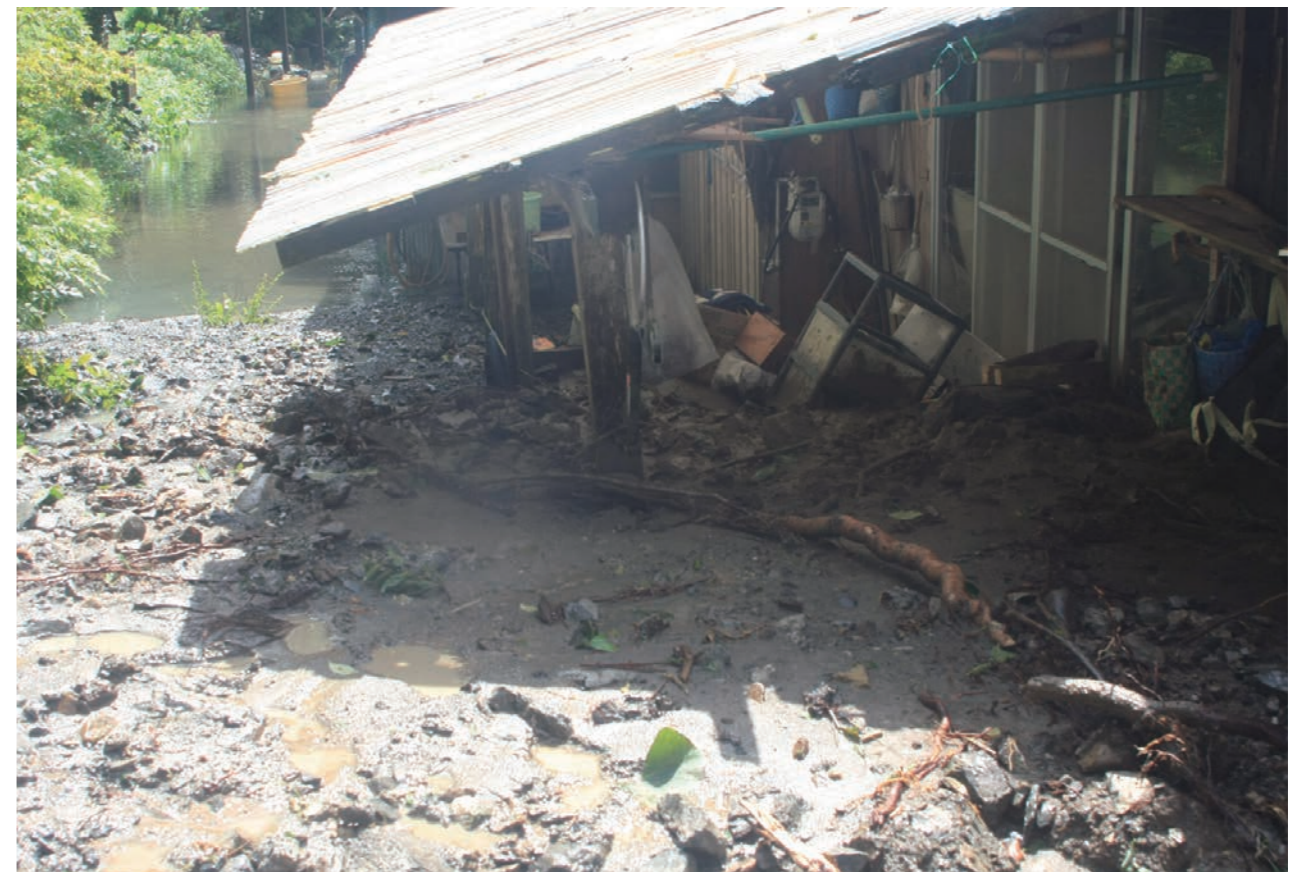
裏山が崩壊して土砂が流入した住家 (朽木村井)
