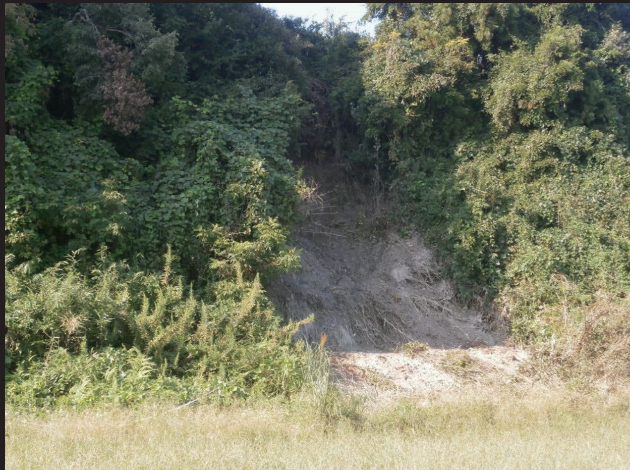
裏山の一部にかけ崩れ発生(新旭町安井川井ノ口)
