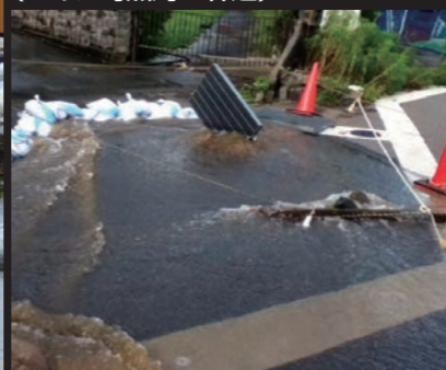
集落内の道路が冠水 (マキノ町山中)
