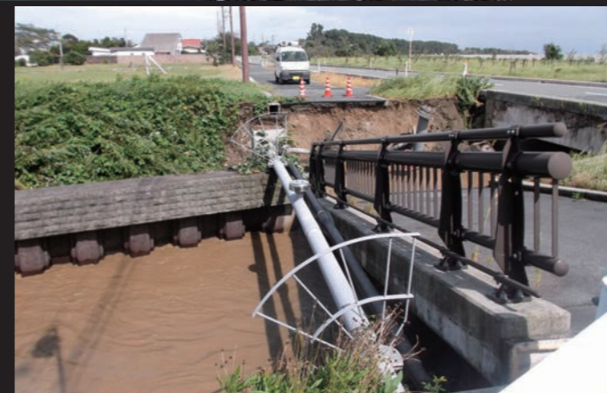
歩道が倒壊(高島萩の浜)
