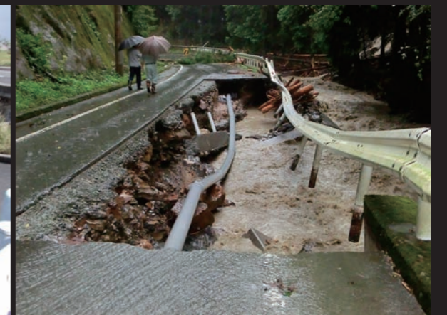
片側1車線が崩壊(高島畑)
