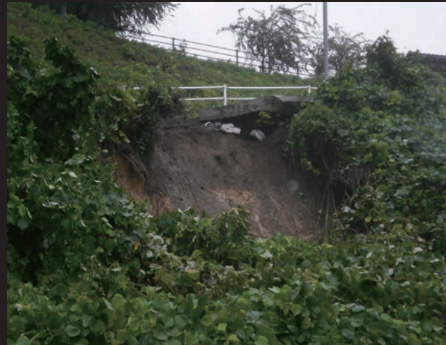
集落内道路法面が崩壊(新旭町五十川)
