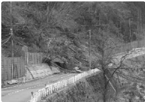
土砂崩壊現場
