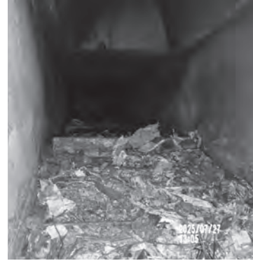
延焼したコンベヤ内の状況 (粗破砕物供給コンベヤ)
