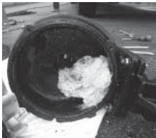
タオルが詰まり破損したポンプ
