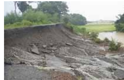
安曇川の堤防（川島地先）。堤防の内側は破損しませんでした。が、堤防に浸透した水により外側の道路がえぐりこむように破損しました。
