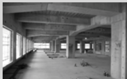
3階の病室部分です。内装工事前はコンクリートの柱と梁だけの広々とした空間です。今後、内装工事が進むと一つの病室の姿が現れてきます。
