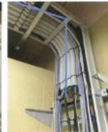
EPS内 立ち上げラック
