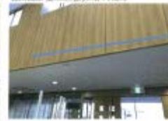
露出配線 壁の上部に沿って配線
