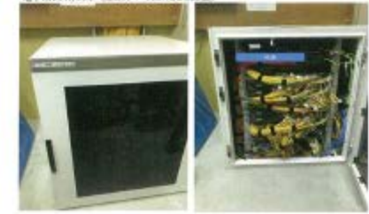
③ 1階EPS 電子カルテ用ラック (サーバスペースCHUBBを設置)
