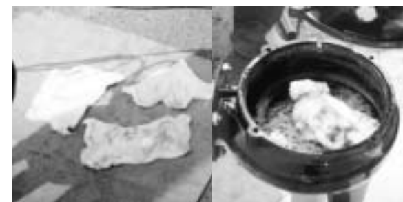
故障したポンプの中からはタオルが
